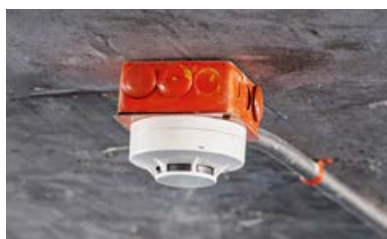
Daneben können auch andere Detektionssysteme wie bspw. Flammenmelder und Rauchmelder zum Einsatz kommen.
