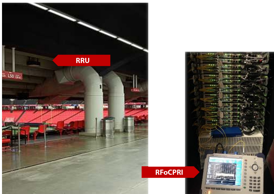
Abbildung 27: Verteiltes Antennensystem (DAS) und CellAdvisor mit RFoCPRI
