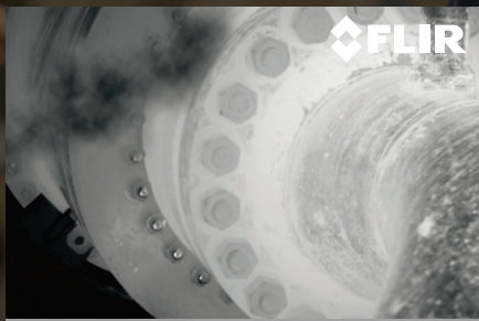
ERDGASLECK AN EINEM VERDICHTERVENTIL
