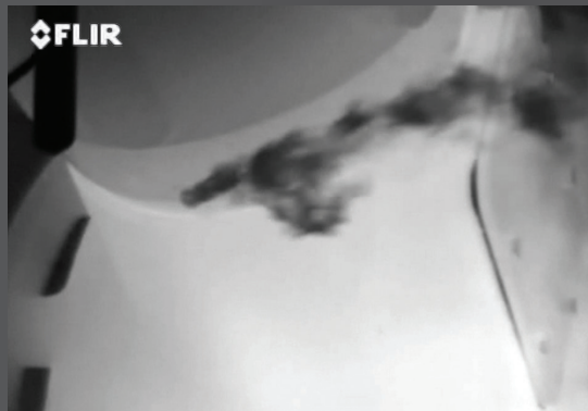
LECKS AN R-124-KOMPRESSOREN ERKENNEN
