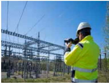
Beurteilen Sie Geräte und verhindern Sie den Ausfall von Komponenten aus sicherer Entfernung.
